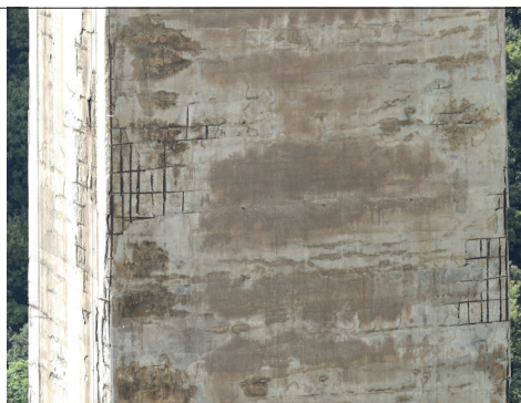
5. Il degrado dei calcestruzzi delle pile della grande luce del Rago
