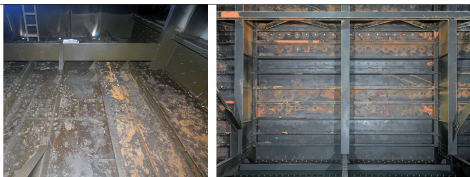
4A e 4B. Degrado lastra ortotropa superiore e inferiore
