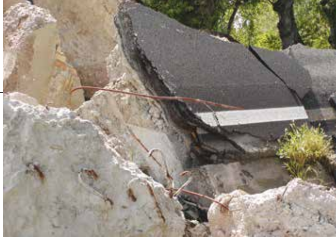
1. Il crollo del ponte sul Sangro lungo la S.S. 16: un dettaglio della pavimentazione
