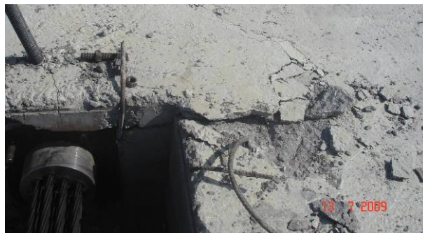
Figura 7 – Cedimento localizzato della zona di ancoraggio trefoli
