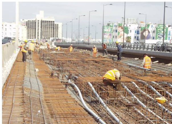
Figura 6 – Posa in opera dell'armatura lenta e delle guaine della precompressione nell'impalcato dell'OA1
